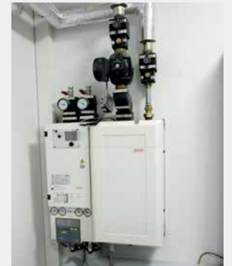
Statt eines raumgreifenden Heizkessels genügt ein Fernwärmeanschluss
